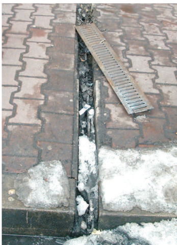
fot. 1. - odprowadzenie wody deszcz. z rur spustowych
