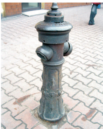
fot. 10. - żeliwny hydrant
